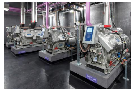
Einer der drei Wärmepumpenräume in der Energiezentrale Torfeld.
